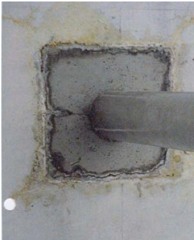
Figur 1 Korrosjon av varmforsinket stål i badeanlegg. Hvite korrosjonsprodukt er og missfarging er ikke pent
