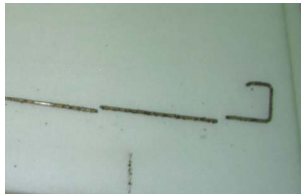
Figur 10 Spenningskorrosjonsbrudd i festebøyer for akustiske plater i tak laget av AISI 316
