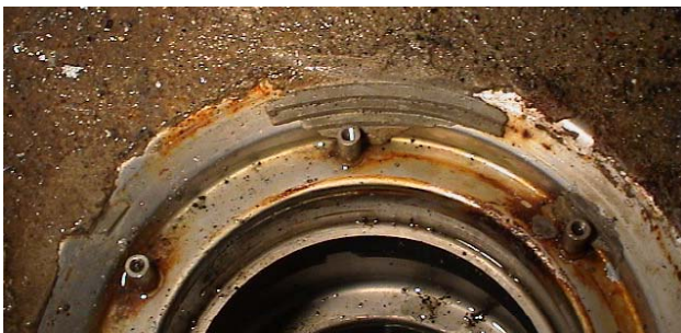
Figur 7 Korrosjon av sluk i spaltene under skrue festene
