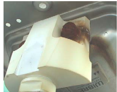
Figur 8 Servant tilkobling der feil material er blitt benyttet
