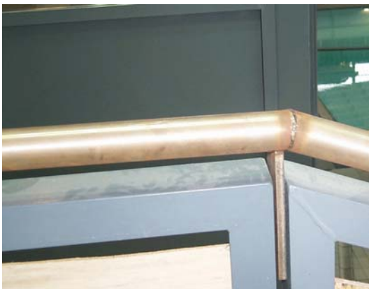
Figur 3 Slørrust/overflate rust på slipt overflate (håndreil)
